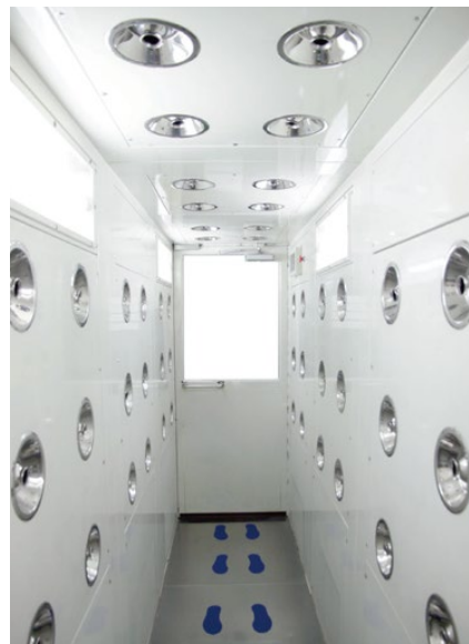
作業用エアシャワー
