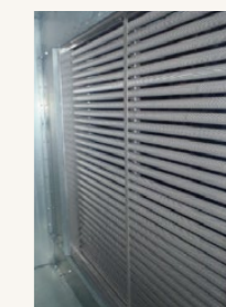
蒸気ヒーター (結露対策)
