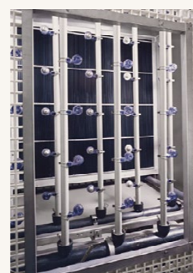
エアワッシャー空調機 (高温工場での暑熱対策)
